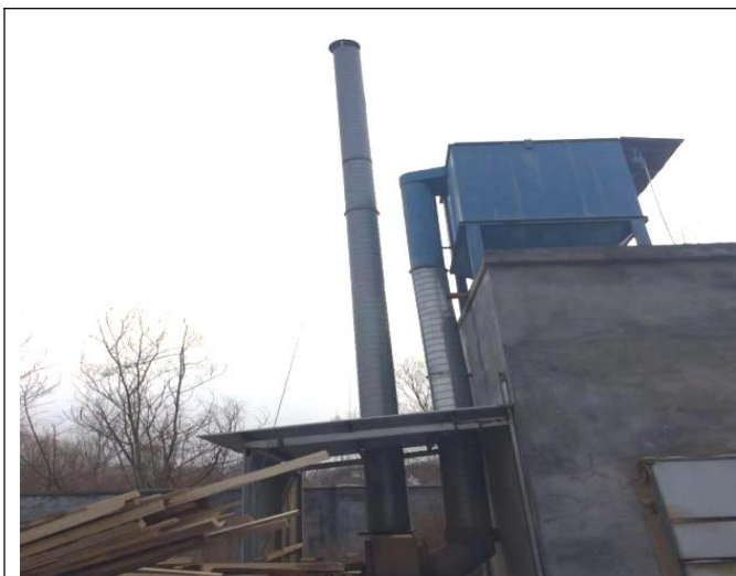
布袋除尘器+15米排气筒P3
