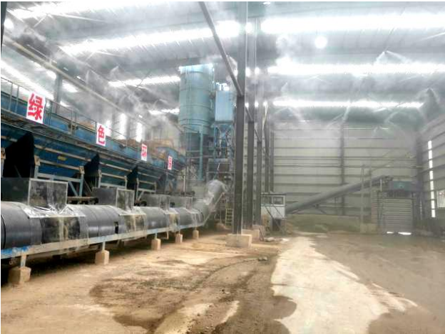
水稳拌合站（北）
