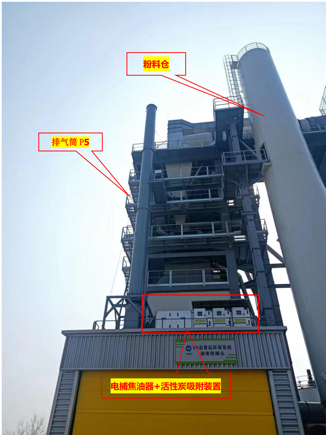
粉料仓、排气筒 P5、电捕焦油器+活性炭吸附装置
