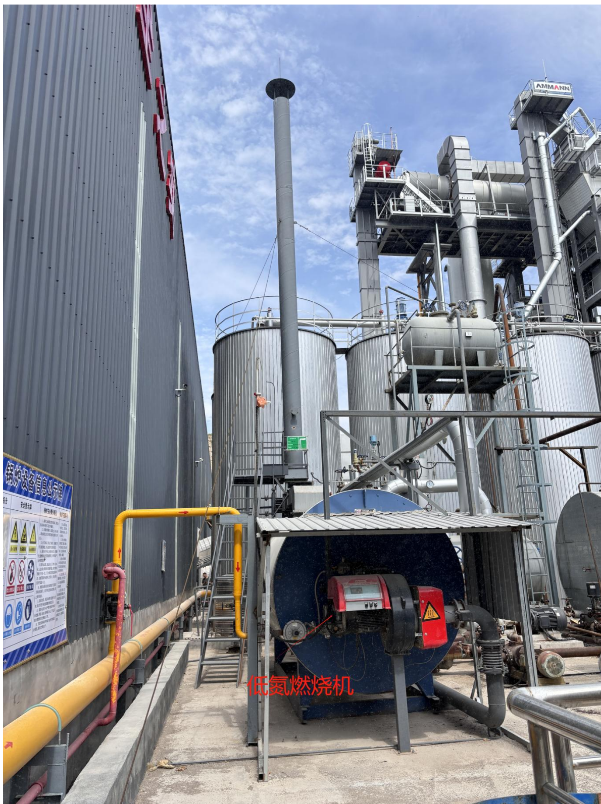
西厂区导热油锅炉排气筒 P3
