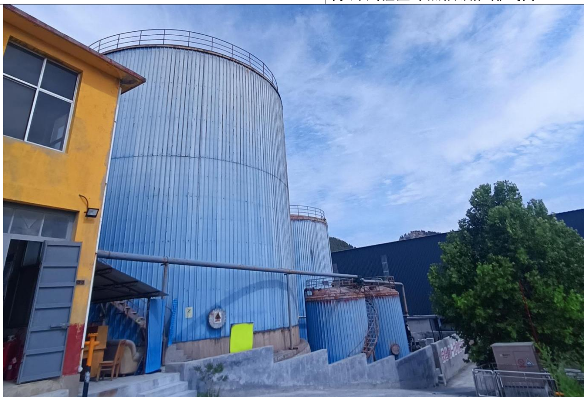
办公试验区沥青罐
