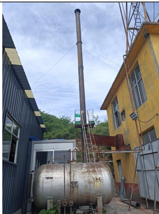
办公试验区导热油锅炉排气筒 P1
