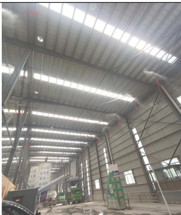
水稳拌合料车间顶部喷淋系统
