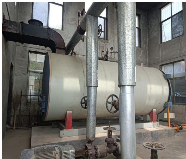
办公试验区导热油锅炉
