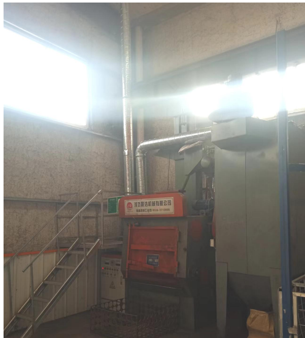
布袋除尘器+排气筒 DA001
